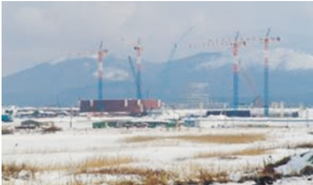
LNG プラント
