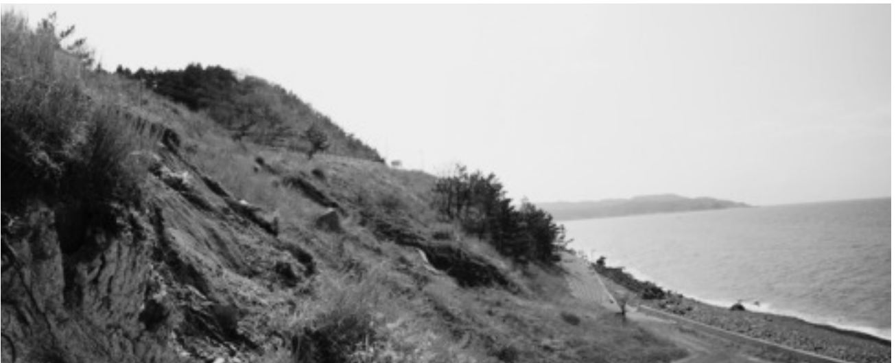
写真－10 国道249号輪島市深見町の道路崩壊 (地滑りの影響か海岸まで崩壊が広がっている)
