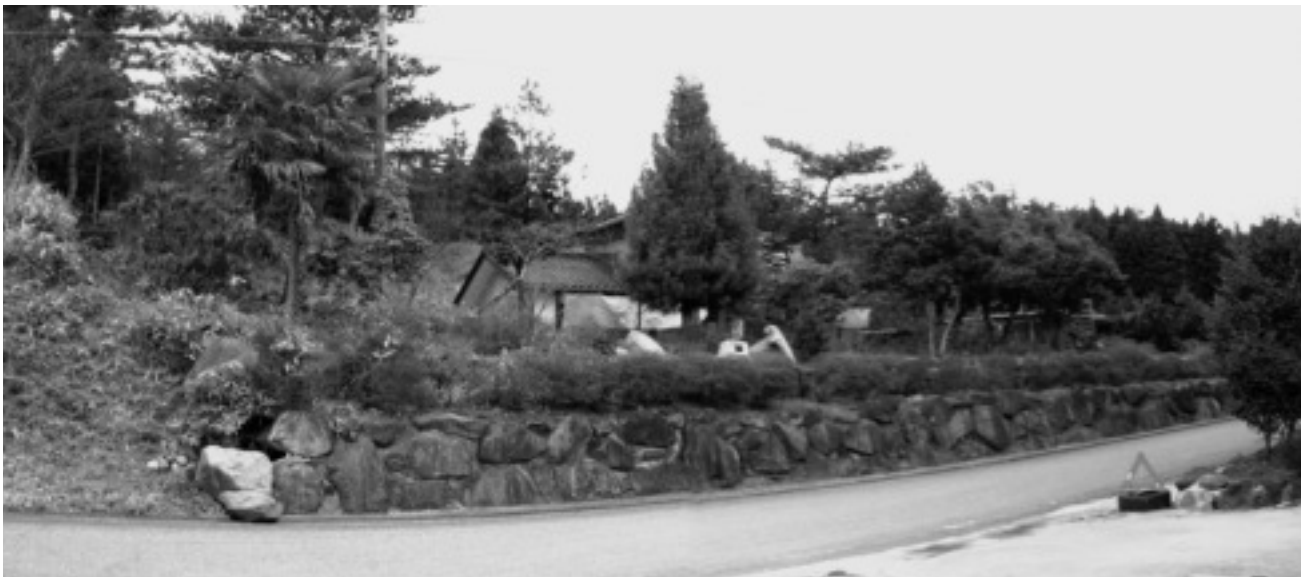
写真－21 穴水町地区の石積の崩壊と石灯籠の倒壊 (局所的な箇所集中的に施設の損壊が見られる)
