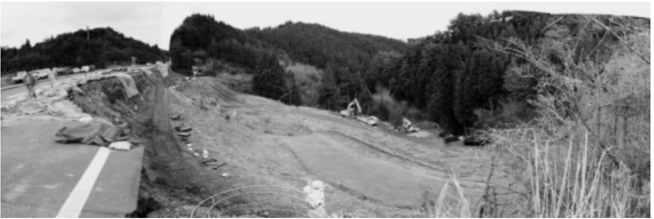
写真-18 能登有料道路越の原 IC 付近の盛土崩壊 (比高差 30 m ほどある)
