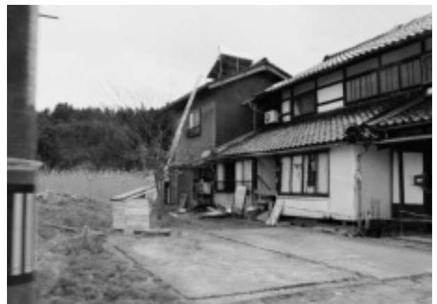
写真－15 穴水町来迎寺地区 (家屋崩壊)
