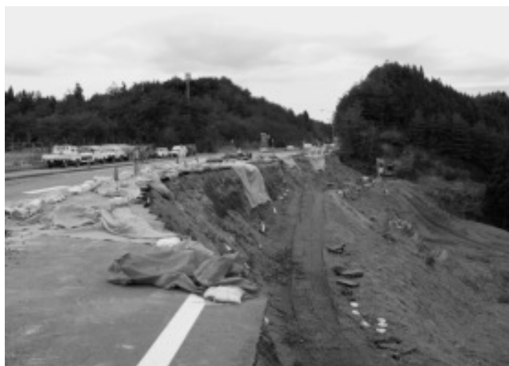
写真-19 能登有料道路越の原 IC 付近の盛土崩壊 (4月27日開通に向けての同上道路の復興作業)
