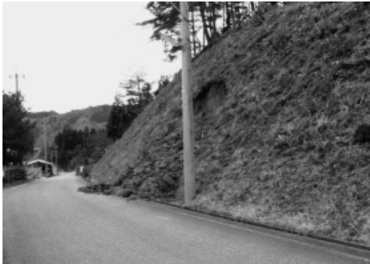
写真－20 穴水町越の原地内小規模な道路崩壊 (穴水付近でこのような箇所が見られる)
