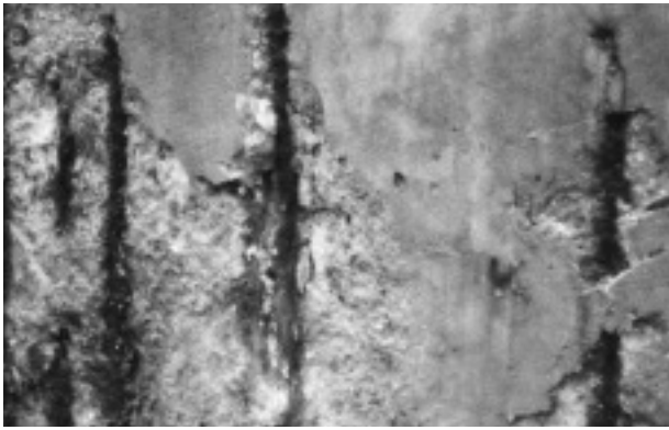
写真-2 ガンター橋に生じた鉄筋の錆とコンクリート剝離かぶりが小さいように見える
