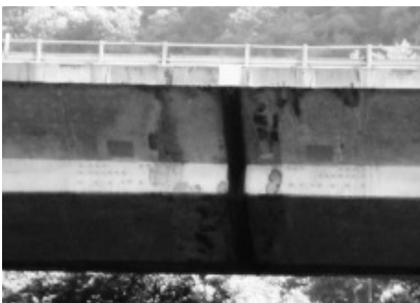
写真-4 シヨン高架橋の補修状況 ひび割れ補修だろうか？
