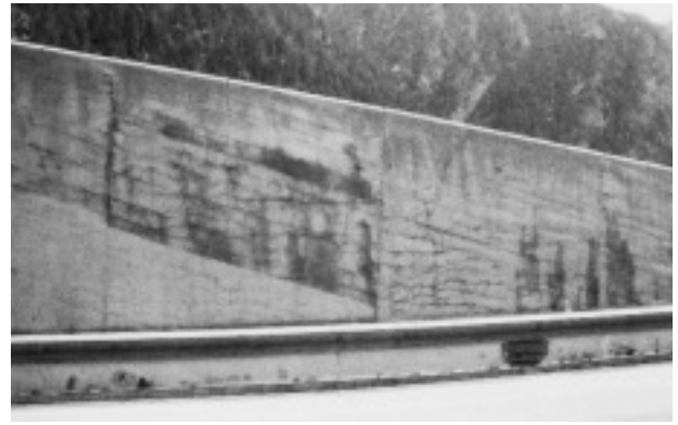
写真-3 ガンター橋の斜版コンクリートのひび割れ 構造的な原因か？ 材料に起因するのか？
