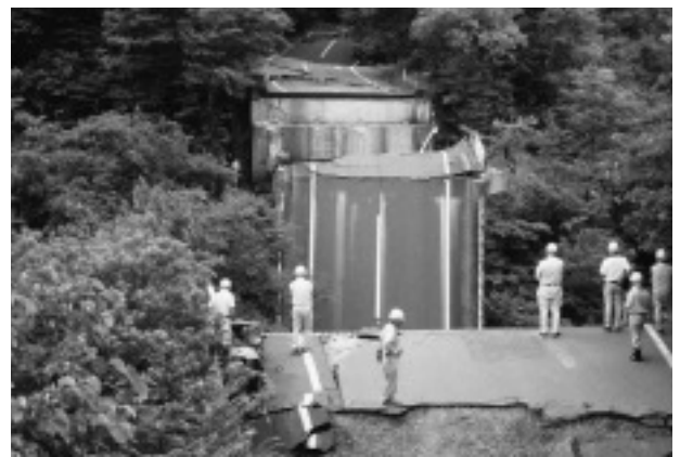
祭時(まつるべ)大橋落橋
