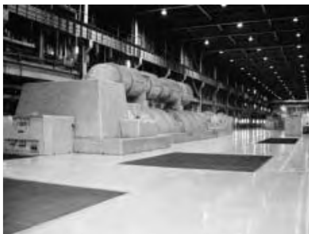
タービン・発電機
