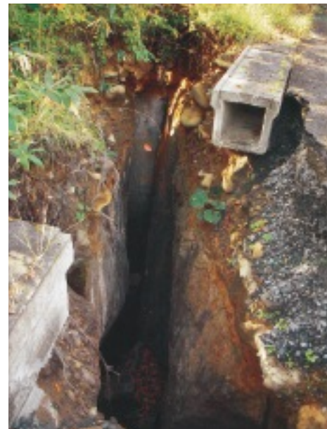
路面亀裂（H20 岩手・宮城内陸地震）
