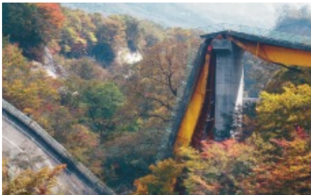
祭時大橋落橋現場（H20 岩手・宮城内陸地震）
