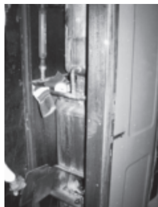
写真4 薪ストーブ(給湯ボイラー)
