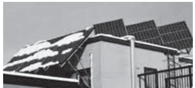
雪の付着状況 左：固定式 右奥：「陽まわり」
