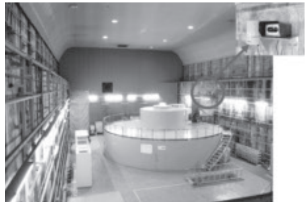
写真-5 「拡散レーザ変位計」本体設置事例(発電所)
