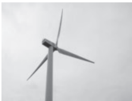
写真-1. 洋上風車ブレード回転状況
