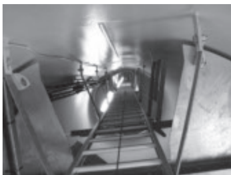
写真-3. 洋上風車の内部
