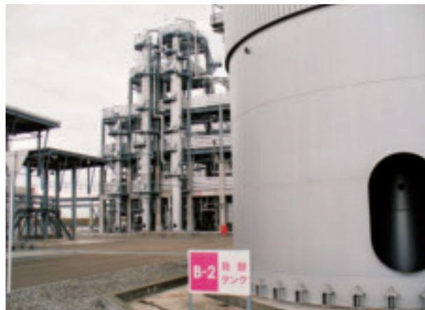
バイオ燃料発酵タンク
