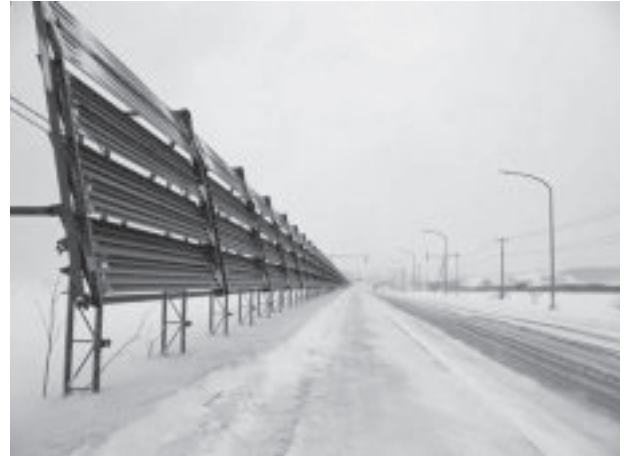
防雪対策(吹き払い柵)
