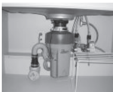
写真-1 ディスポーザー設置状況
