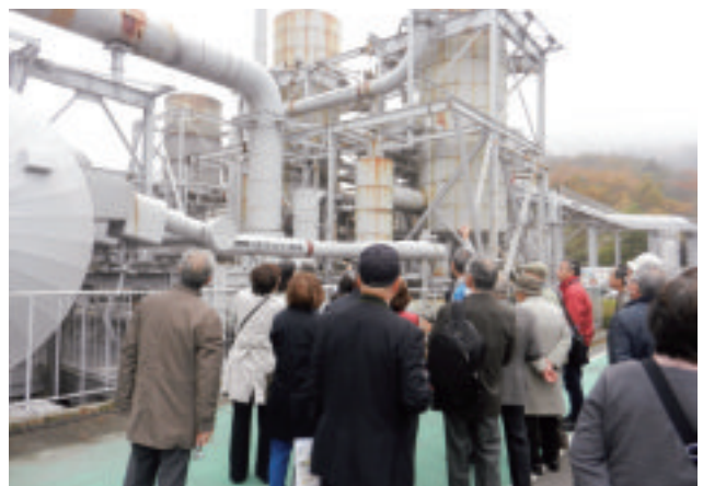
テクニカルツアー B(2日目) 八丁原地熱発電所
