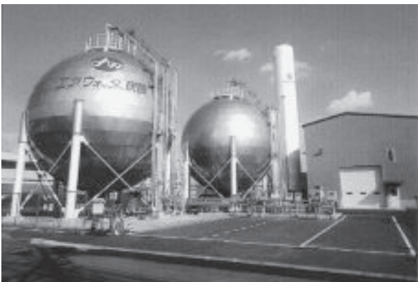
写真-2 炭酸ガス液化精製設備外観
