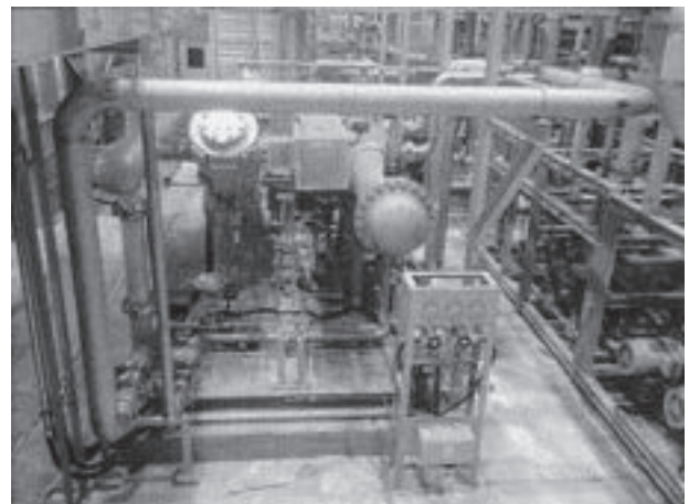
写真-4 CO 2 圧縮機
