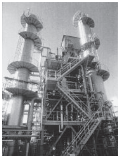
写真-8 炭酸ガス回収設備(ESCAP)
