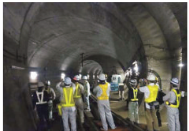
横取基地と列車火災検知装置
