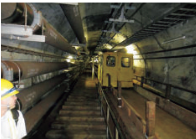
吉岡斜坑内のケーブルカーと排水管
