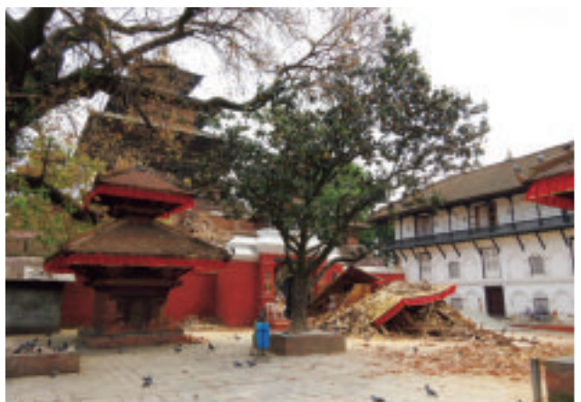
口絵-12 破損した入口
