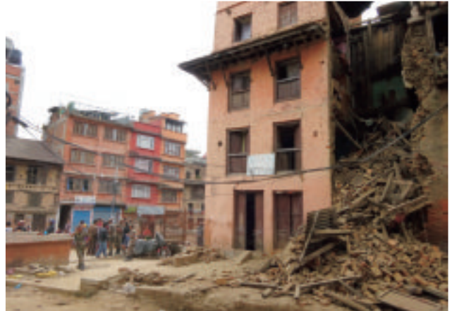
口絵-20 広場で崩壊したレンガの建物
