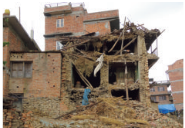
口絵-34 崩壊した建物の断面
