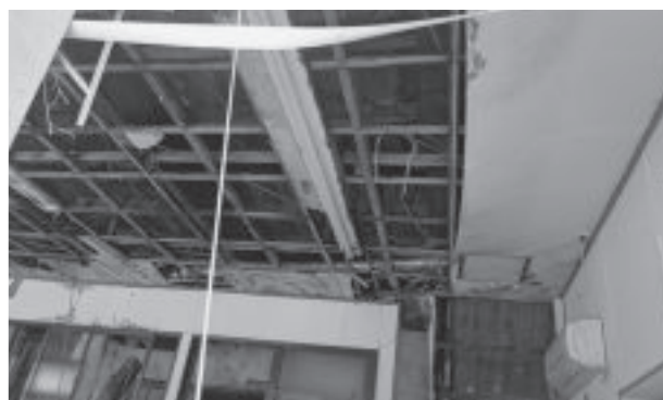
写真-23 崩れ落ちた天井
