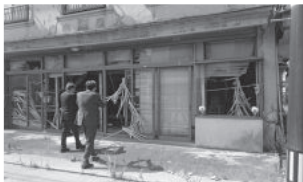
写真-22 荒れた商店外観
