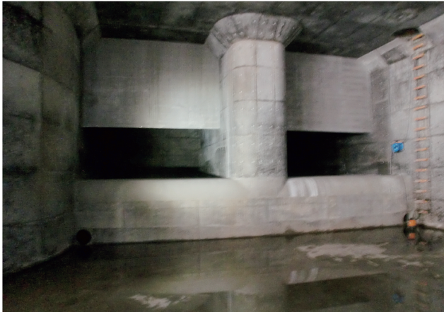
呑口部：沈砂池、オリフィス孔
