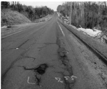
道路に発生したポットホールの例
