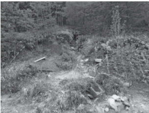
大雨で崩れた道路法面
