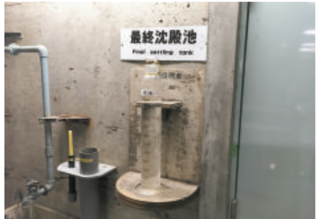
最終沈殿池処理水
