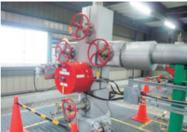
CCS 実証試験センターのCO2 ガスの地下圧入装置
