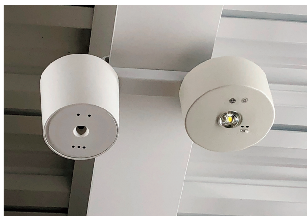
照明に設置されている明るさセンサー(左)と 人感センサー(右)
