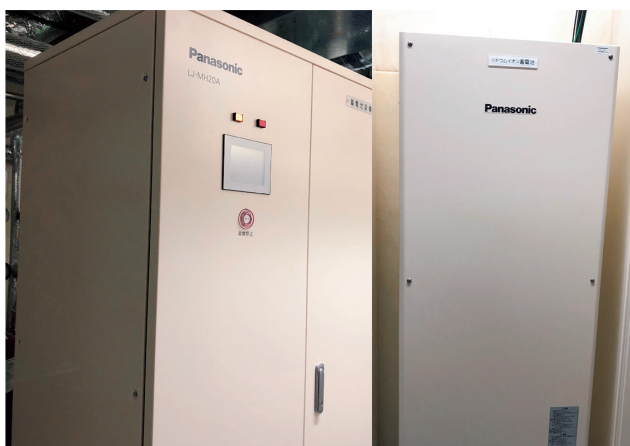
太陽光発電用蓄電施設、動力系統 20kWh (左)、 電灯系統 11.2kWh (右)
