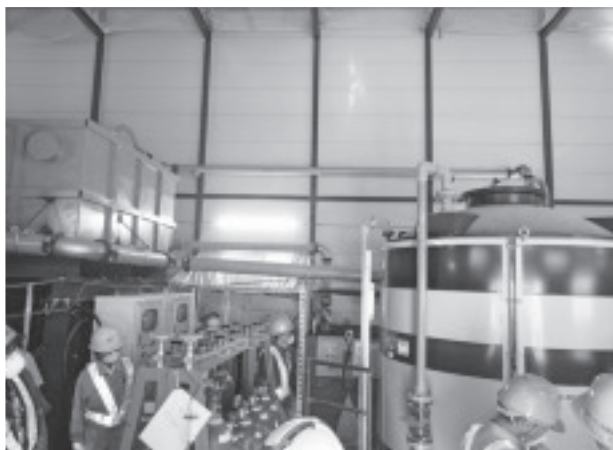
図-12 濁水処理プラント内部
