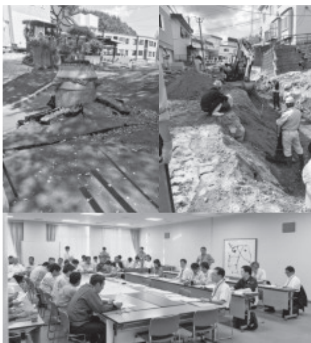
写真-10 管路の被災と復旧会議(胆振東部地震)
