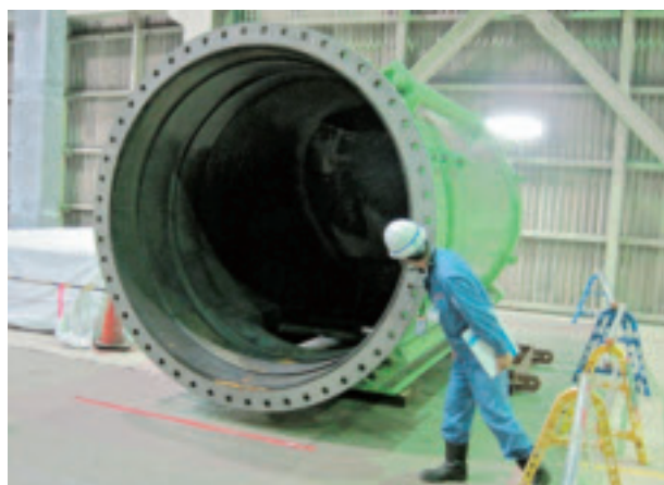
発電所設備の一部(工事中の資材)
